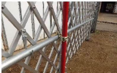
補強用単管ポール差し込み後 カンヌキ単管にクランプにてジョイント
